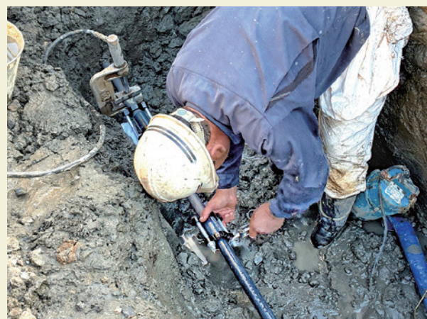
漏水を減らし無駄のない配水を
