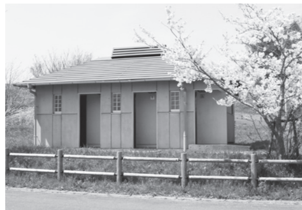
改修が求められる志摩城跡近くのトイレ
