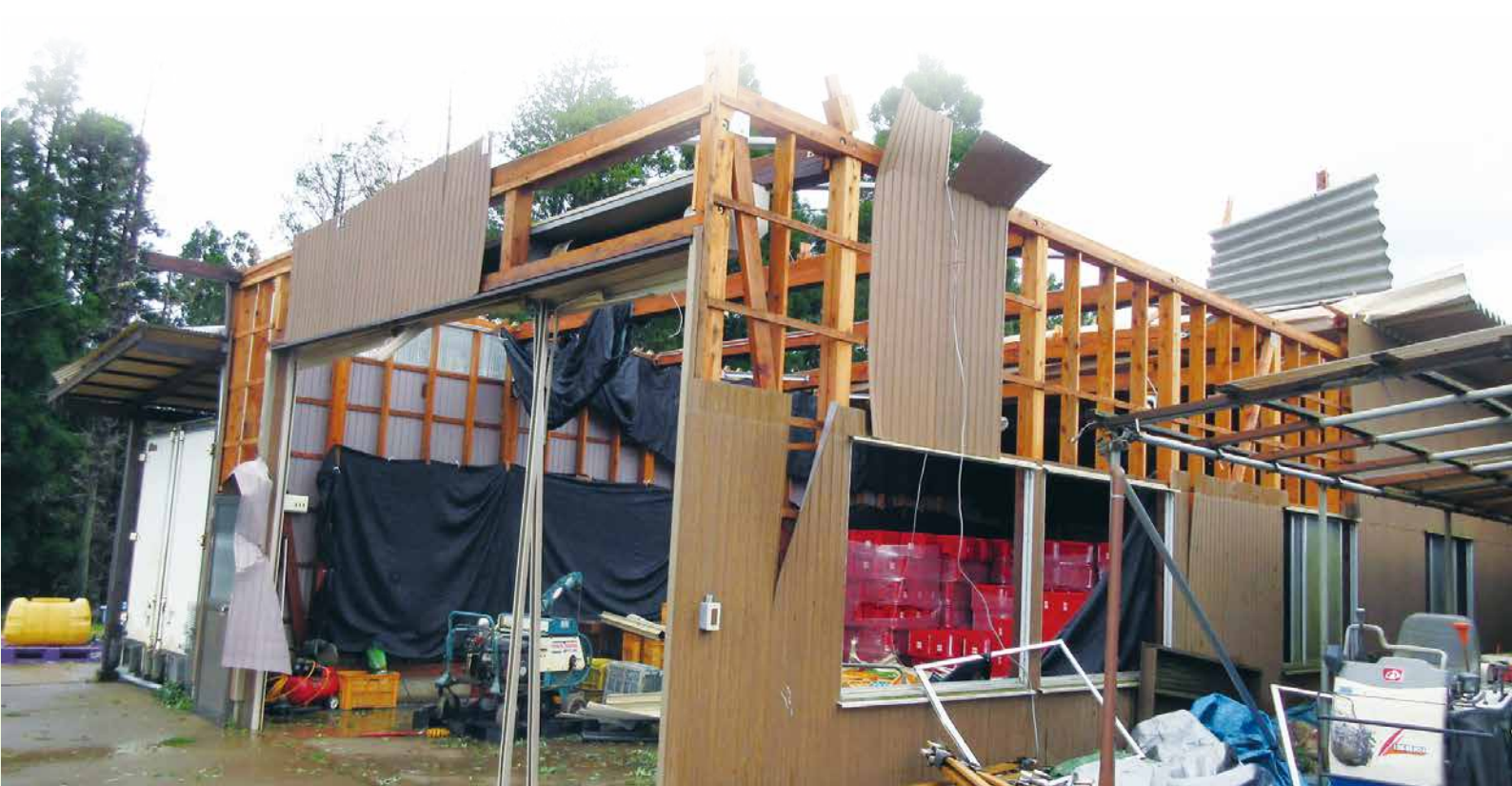
台風の被害を受けた作業場
