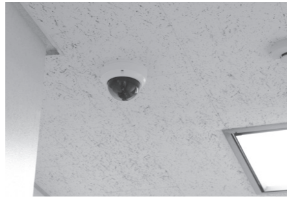
庁舎内の防犯カメラ
