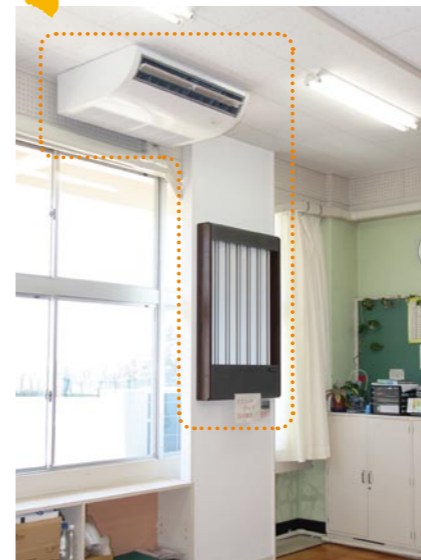
本格導入に向け実証中の輻射方式空調設備
