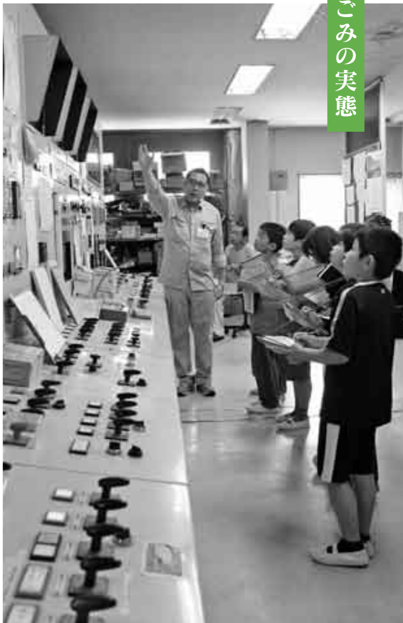
運転中の焼却炉制御室・クレーン操作室で熱心に説明を聞く児童たち
