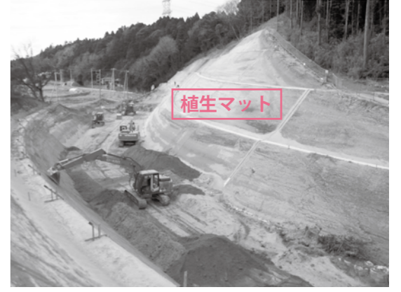
町道飯笹・西古内線の切土工事現場(通称1000mカーブ付近)を御所台から高津原方面に向かって撮影 ▶
