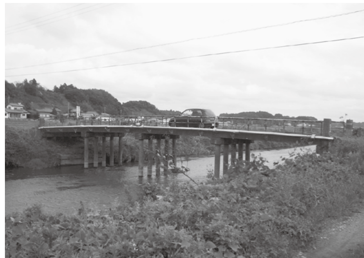
老朽化する中久橋（神行一作）
