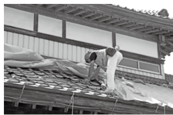
大震災で屋根瓦が崩落した住宅
