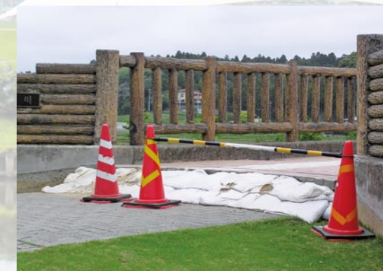
地震により段差ができたあじさい橋
